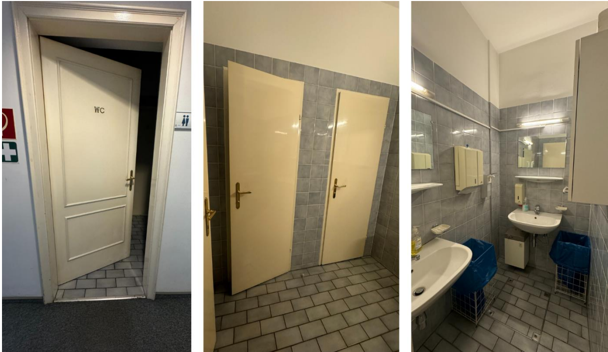
Abbildung 19: Nicht-barrierefreie Toilette in der Universitätsstraße 5, 1. Obergeschoss
