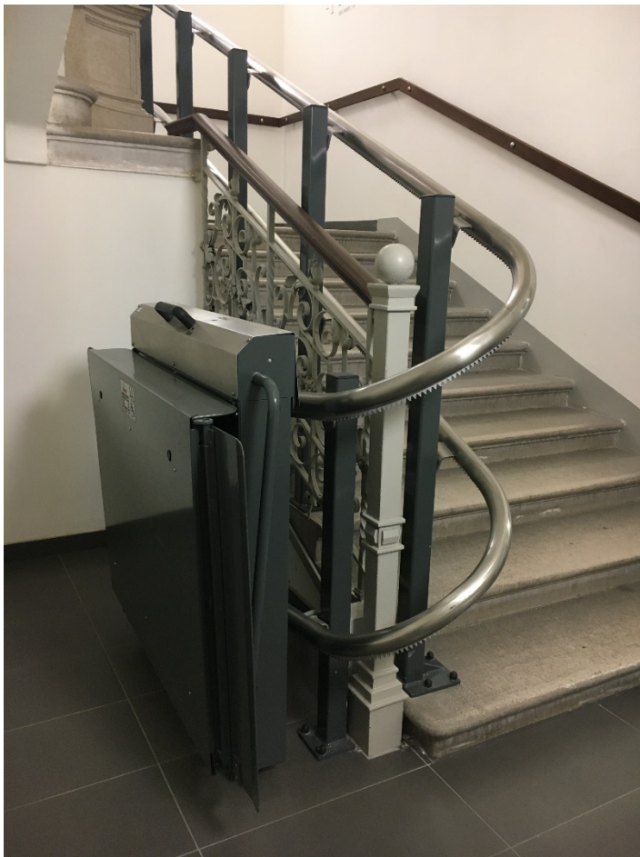
Abbildung 9 Treppenlift Abgang zum Tiefparterre
